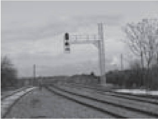
Foto 15.- Señal luminosa absoluta de salida en nacela sobre pórtico de celosía instalada en Cabra del Santo Cristo. Enero de 2009. Foto Mario Fontán Antúnez
