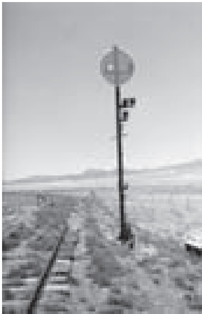
Foto 11.- Disco tipo Sur de España en estado casi de origen, ya fuera de uso en el ramal de Minas de Alquífe. La foto nos permite observar el tipo de montaje que realizó Fives-Lille en estos aparatos. Junio de 2001. Foto
