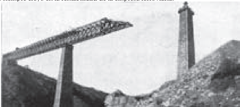
Foto 6.- Trabajos de lanzamiento de uno de los tramos del Viaducto del Salado. Foto López-Baeza.
